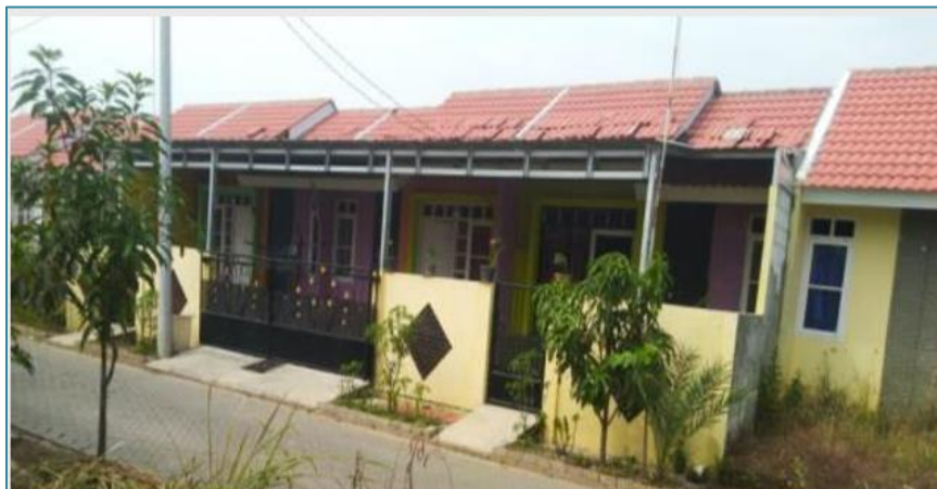
Di lapangan ditemukan rumah subsidi 4 unit yang digabung menjadi satu kesatuan bangunan..
